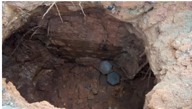
NECESSIDADE DE REPAROS EM CAIXA DE PASSAGEM EM VIA PUBLICA
