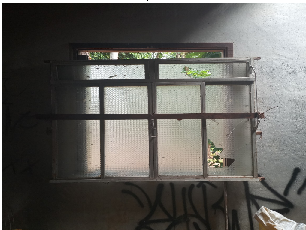
FIGURA 2 – Situação das esquadrias
