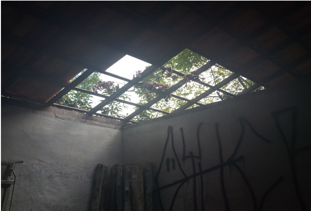
FIGURA 1 – Atual situação do telhado da casa Numear
